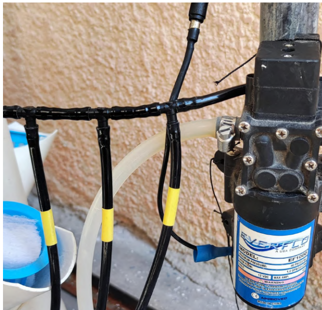
Figura 3.5: Mangueras conectadas a la bomba de riego
